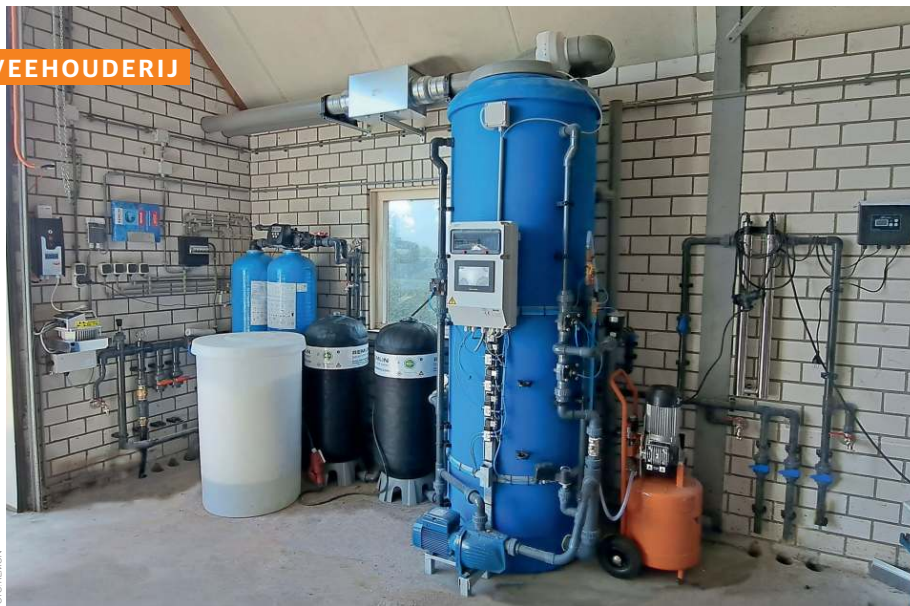
Een gesloten waterbehandelingsysteem met multifilter van Remon voor ontijzeren, beluchten en ontgassen van bronwater. De brongassen gaan via afvoerbuizen met ventilator naar buiten.
